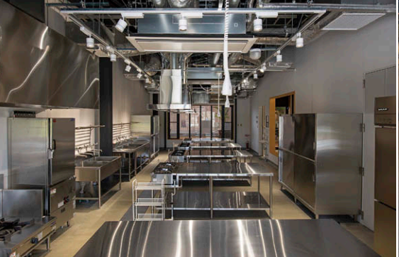
レンタルキッチン メンテナンスがしやすいように露出させた機械設備やダクト、ライティングレール。
