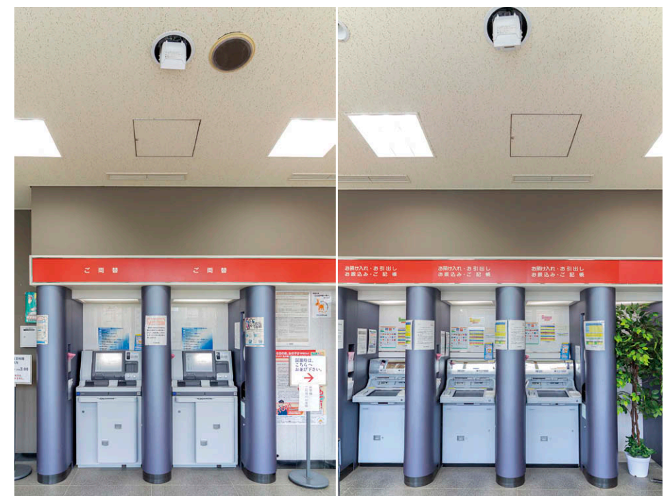
両替機コーナー 両替機2台に対してUVeeユニバーサルダウンライト①1台でUV照射して除菌。 ATMコーナー 4台のATMに対して2台のUVeeユニバーサルダウンライト①を設置(写真は右2台用)。
