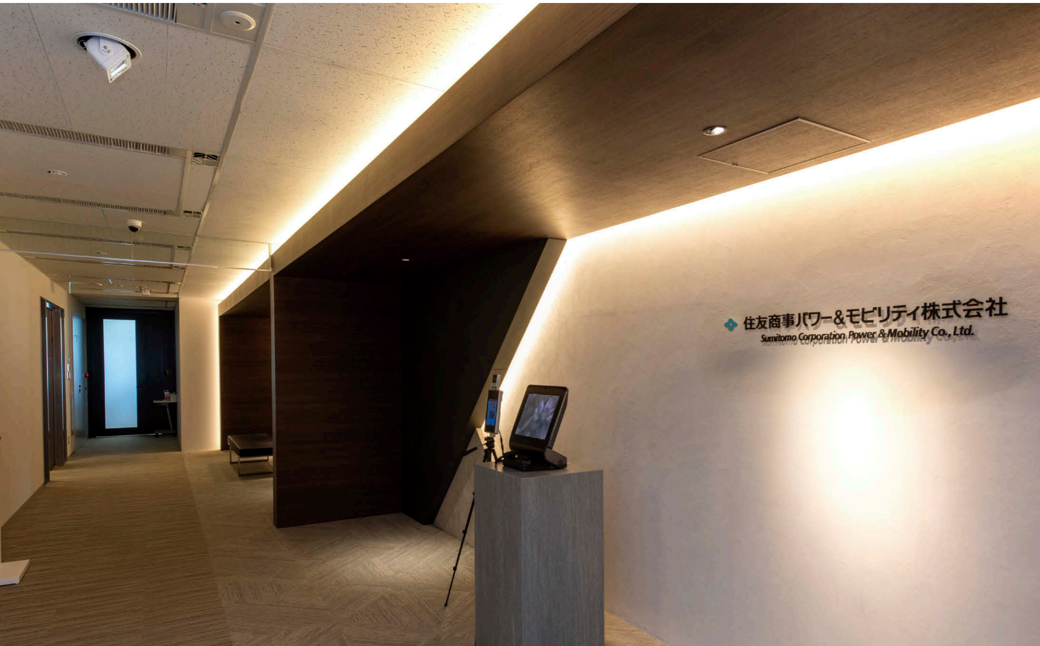
6階エントランスに設置した UVee① UVeeは天井高2.6mに設置し、来社受付機までの距離は2.1m、照射角は45度。
