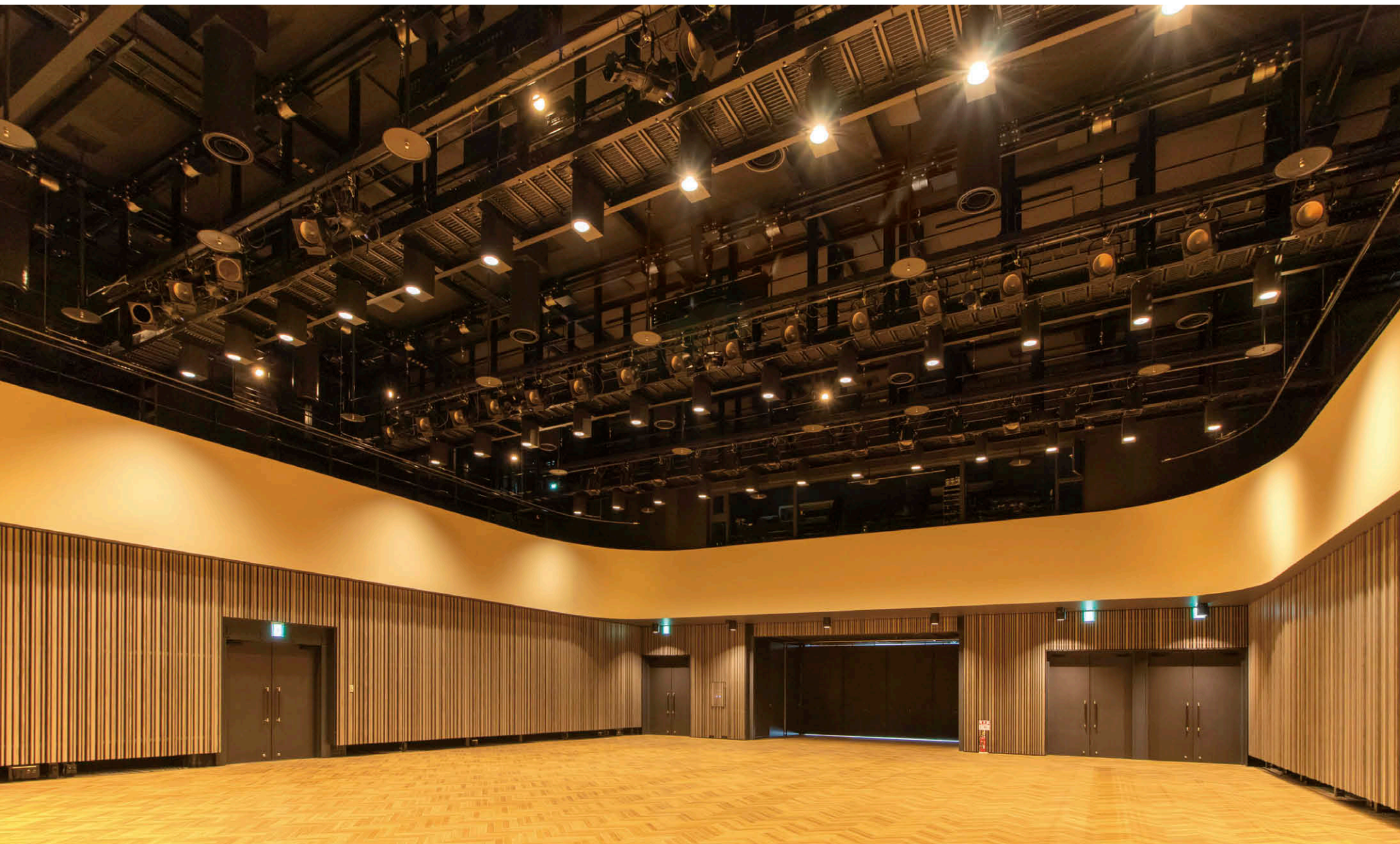
ライカ南国ホール 特注吊ボックスを用いてキャットウォークにLEDシアターシリーズダウンライト①を配置し、調光と色温度が連動する劇場空間のあかりを実現。
