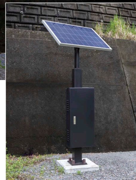
0.67㎡に大型化した太陽光パネルに60Ahバッテリー2台を内蔵したLEDソーラーライト電源部。
