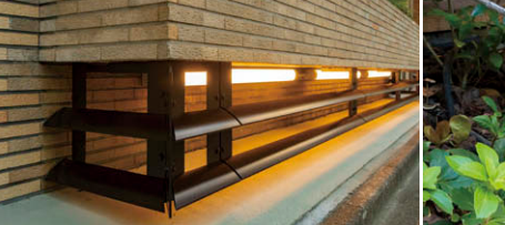
(上) LED 軒下用調光ダウンライト採用⑨のエントランス玄関周辺。 (左下) LED ベースライト防湿防雨形器具④を設置した花壇下部。 (右下) 植栽を下から照らす LED スパイク式スポットライト②
