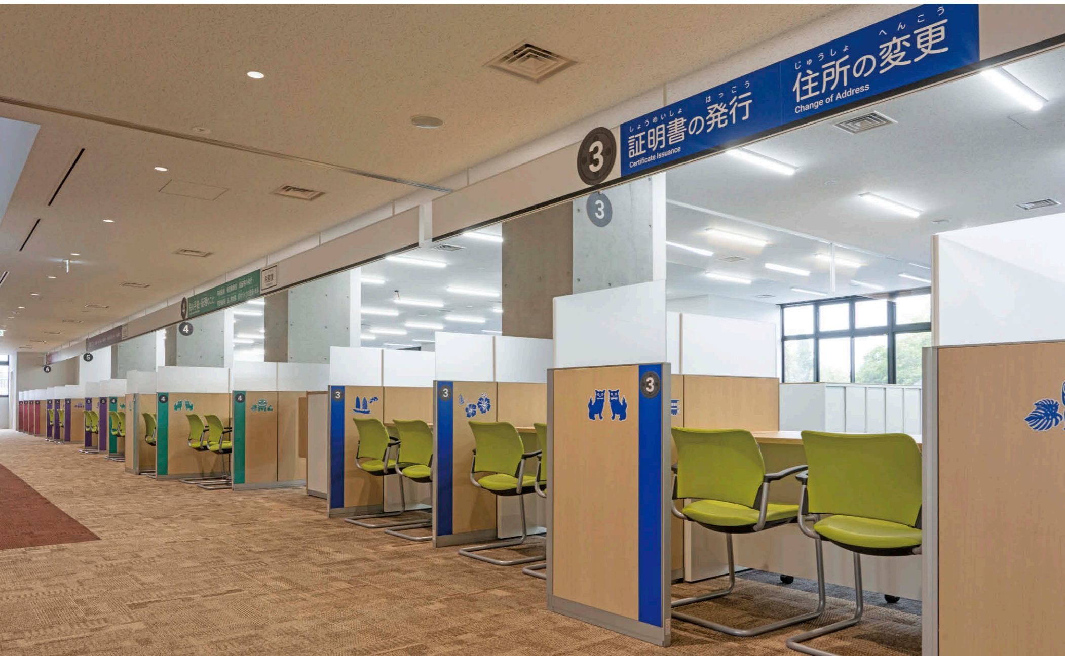
2階 執務室のTENQOOシリーズ直付形①による照明。
