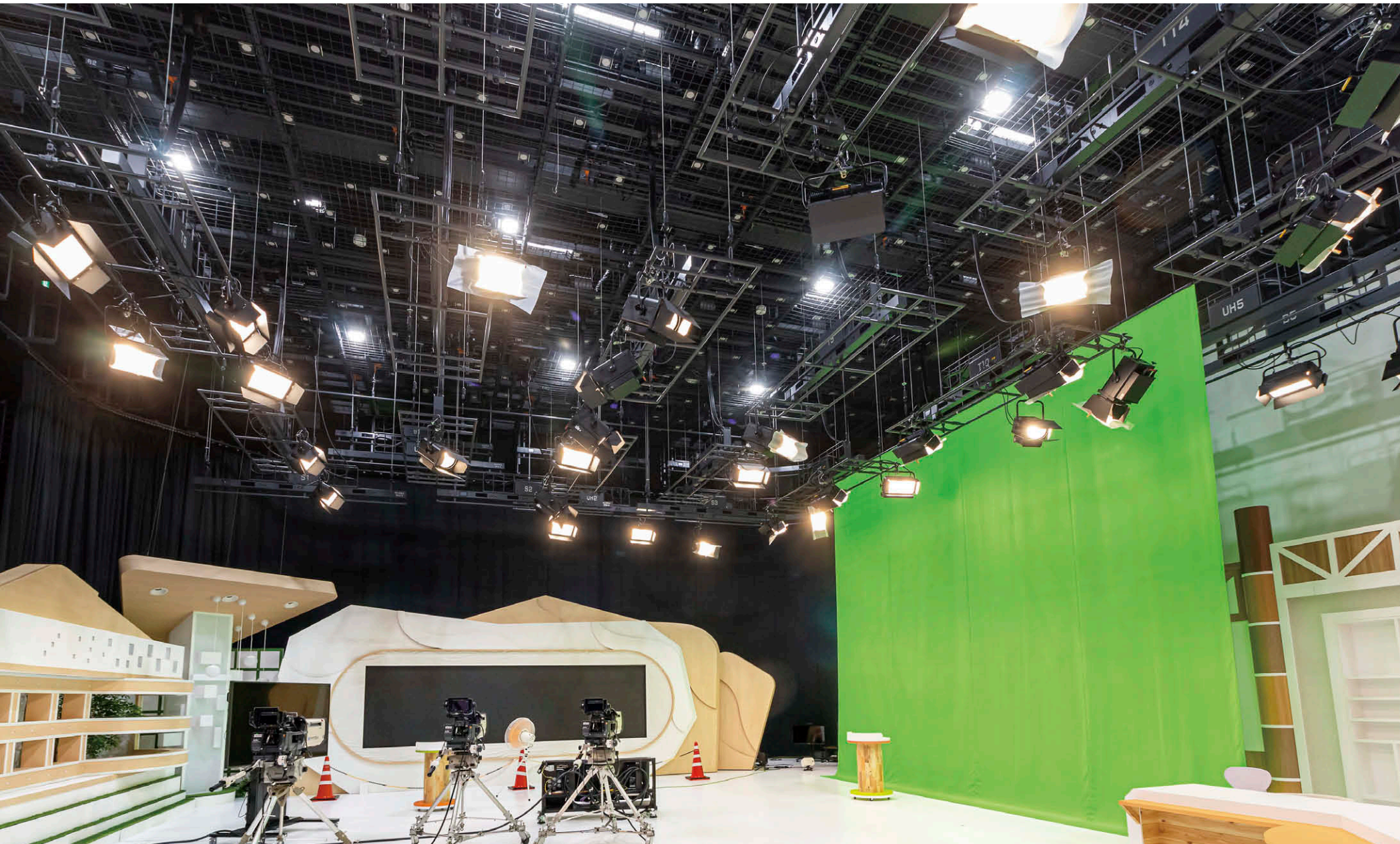
メインスタジオ 照明器具には電球色相当のスタジオ用 LED ブロードライト①、LED スポットライト②を採用。報道スタジオでは、昼白色相当の器具を採用。
