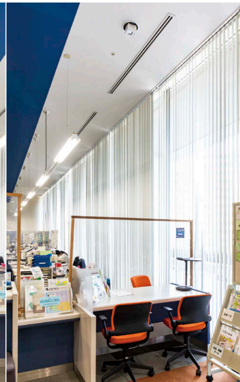
施設利用の相談カウンター デスクから3.6mの天井にUVec ①を設置。
