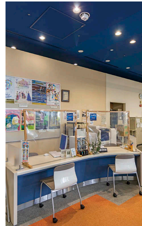
施設利用の申込みカウンター デスクから3mの天井にUVec ①を設置。
