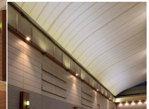
シネマ側設置状況 膜を均等に照らすため天井コーナー部から2mの間隔を空けて横長タイプ③を上向きに20台設置。同高さに電球色器具②を下向きに10台設置。
