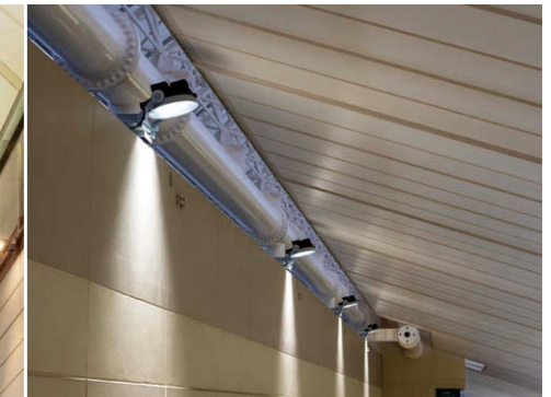
店舗側設置状況 器具光束65,000lmのLED投光器①を高さ17.4mの位置に約11mの間隔で配置。
