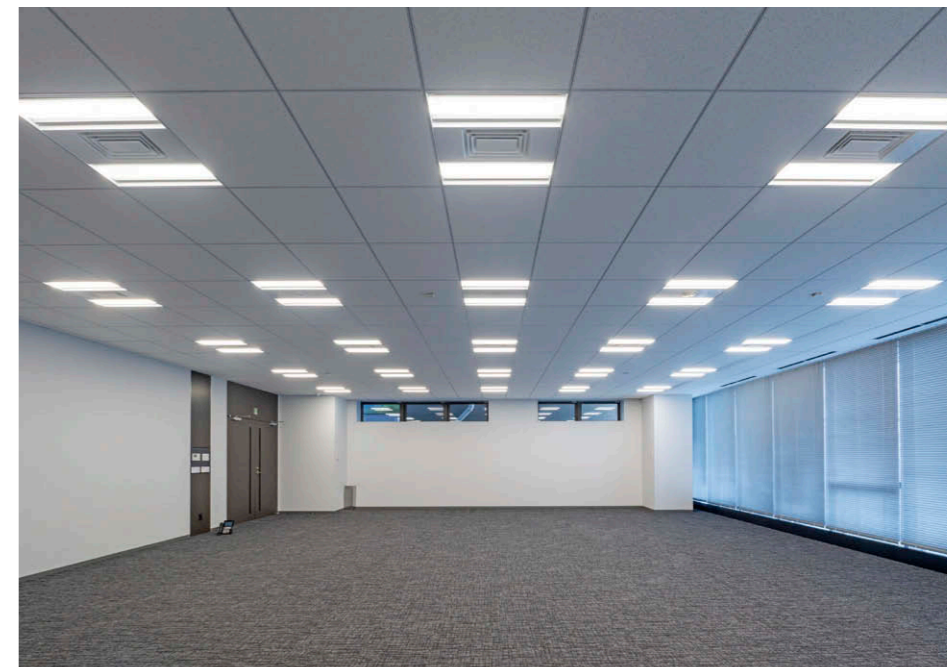
貸室（奥側より望む）調光センサーにより、システム天井用器具グリッドタイプ①の照度を自動制御し、常に平均机上照度 750 ルクスを保つ設定。
