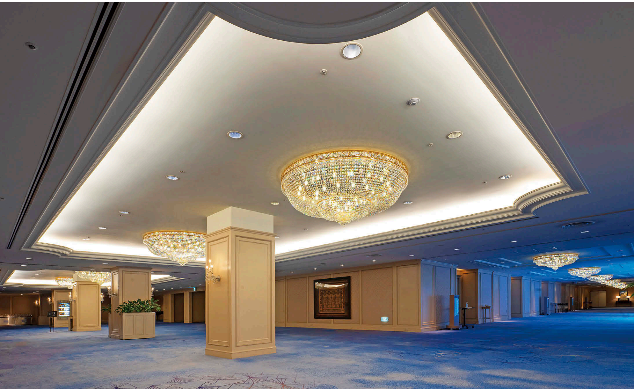
天井高 2.6m のホワイエに間接照明として TENQOO シリーズ①と宴会場入口に LED ライン器具②を配置。
