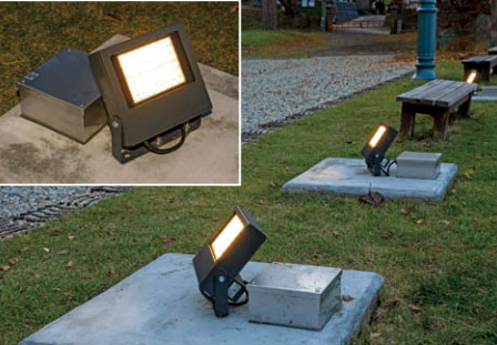
既存器具位置に置き換えた重耐塩形のLED小形投光器①
