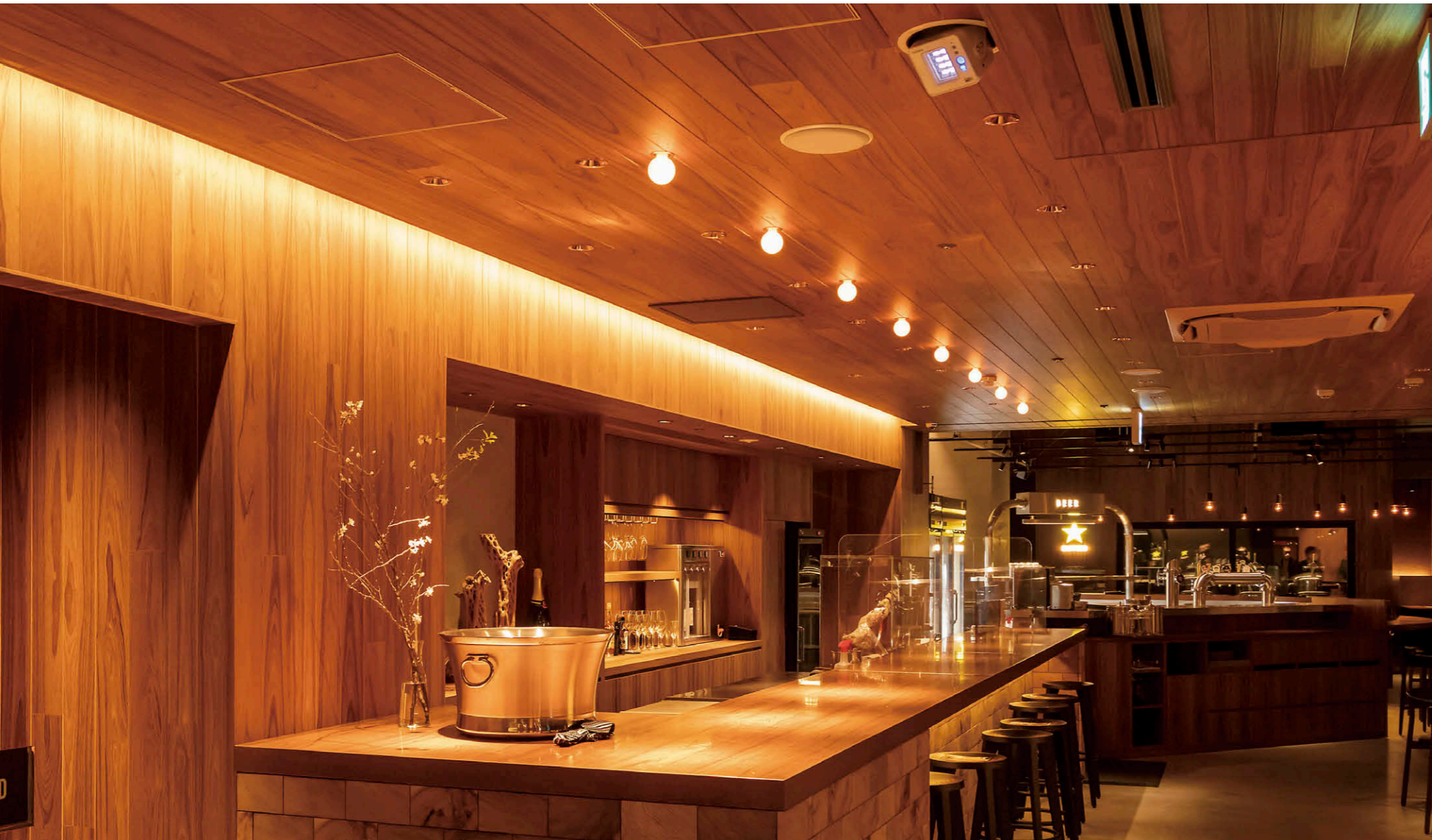
出入口付近からカウンターを望む 「人感センサー運転」に設定した UVec ユニバーサルダウンライト①が無人環境で UV を定期的に照射しウイルス抑制・除菌を自動化。
