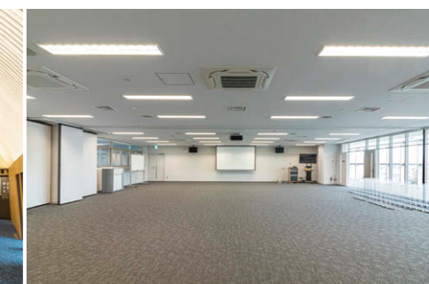
3階会議室 LEDベースライトTENQOOシリーズ埋込形⑤を採用。
