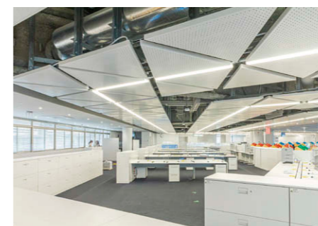
2階執務室 昼光センサーによりLEDベースライトTENQOOシリーズ①の明るさを自動制御。
