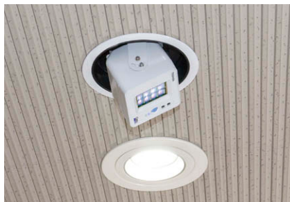
受付前天井に取り付けたウイルス抑制・除菌用UV照射器UVec①
