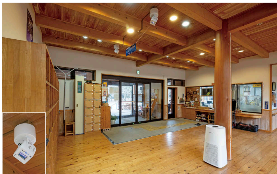
エントランスホール 2台のUVee直付タイプ②が下駄箱側を狙って除菌。
