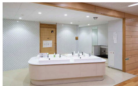
2階洗面台 4つのシンクのある洗面カウンターへUV照射。
