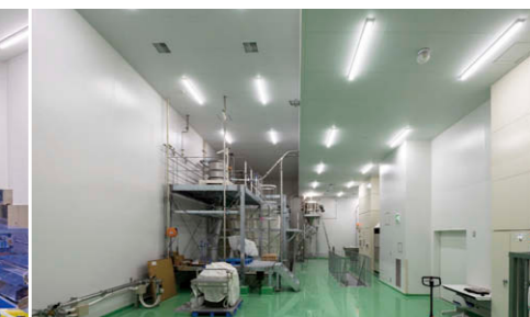
サイロ室 5,200lmタイプのLEDベースライト③を採用。
