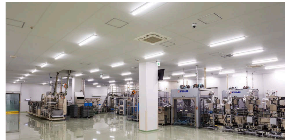
結束包装室の照明風景 白色系の内装と整列配置された昼白色のTENQOOシリーズ一般タイプ6,900lmタイプ①により、清潔感ある空間を創出。
