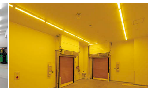
入出荷室 イエロー光LEDパー低誘虫タイプ④を7灯2列でライン状に配置。
