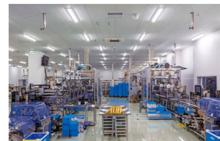
結束包装室 包装工程付近には12,000lmタイプのハイパワー器具②を採用しより高い照度を確保。
