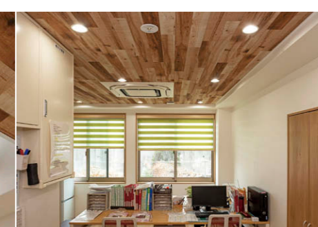
1階執務室・医務室 LEDダウンライト⑦を10台採用。
