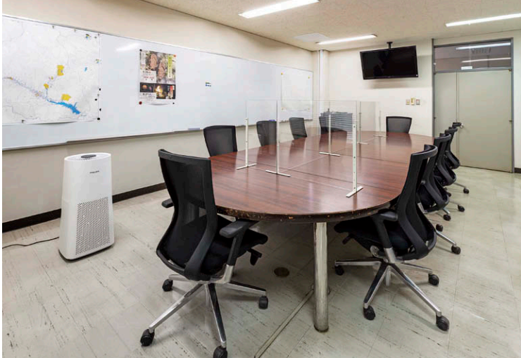
2階第1会議室 多人数の集まる空間にはUV-C室内空気除菌機②を導入。
