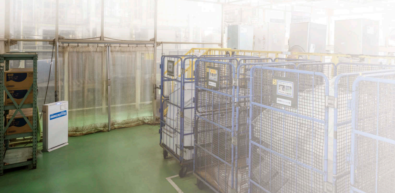
工場棟 / 家電リサイクル冷蔵庫前処理の専用ブース 換気がしにくくニオイがこもりやすかった冷蔵庫の処理ブース内にUVish据置タイプ100を設置。気になるニオイを脱臭して快適な作業空間を創出。
