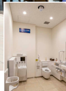
男・女・多機能トイレに各1台ずつウイルス抑制・除菌用UV照射器UVec⑩を設置。
