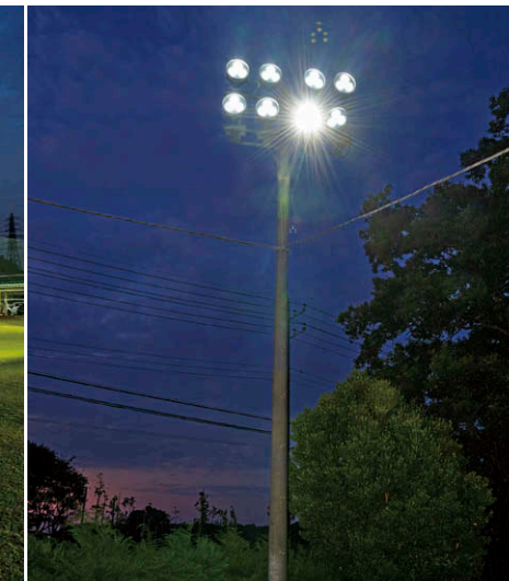
照明塔 高さ約10mの既設照明塔。片側に6台、片側に8台のLED投光器①②③を配置。
