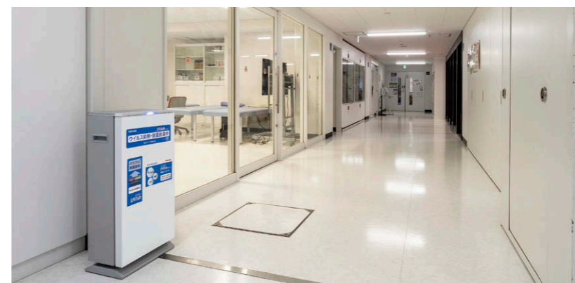
アスレティックヴィレッジⅡ（男子寮） 廊下に設置された UVish。
