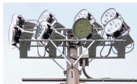
リニューアルされたLED投光器と取付架台。
