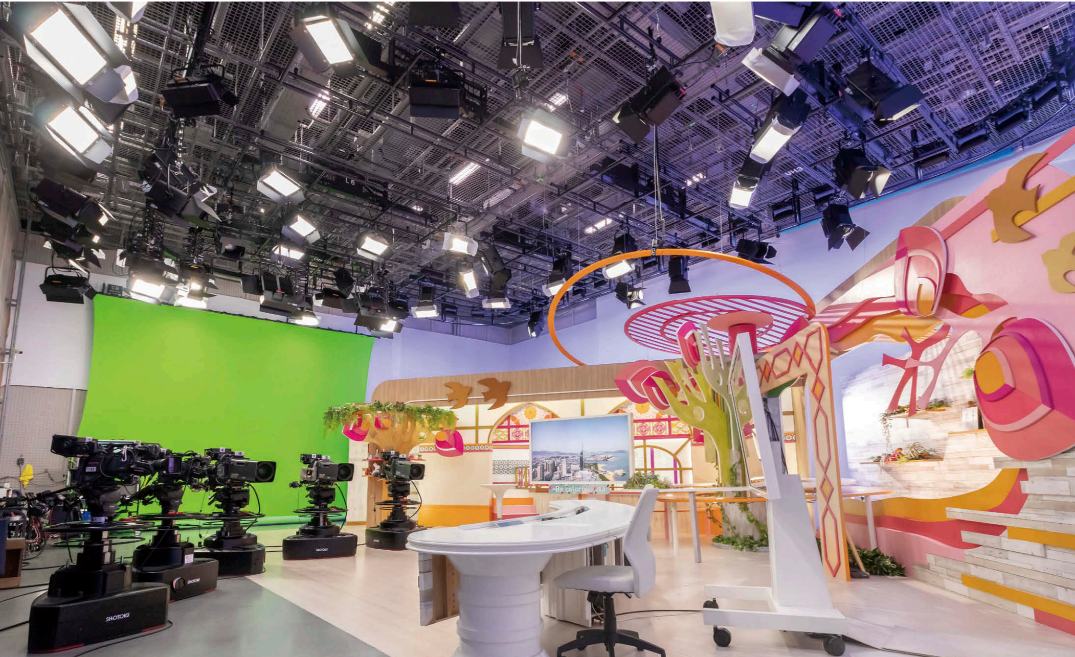
情報番組用セット風景 8掛のトラスバトンと7掛のバックバトンに48台のLEDスポットライト①と30台のLEDブロードライト②③が吊り下げられ、固定アッパー水平バトン4掛にはLED水平ライト④を36台配置。
