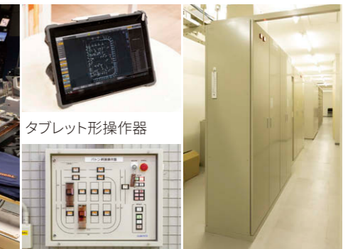
昇降操作盤 照明ラック室
