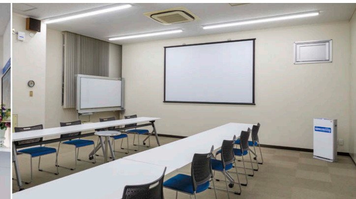
1号棟 会議室 3部屋ある会議室に1台ずつUVish①を設置。
