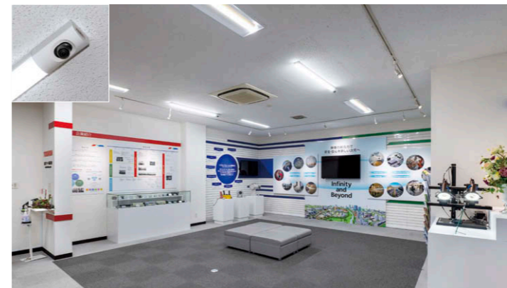
1号棟 ショールーム カメラ付きLED照明ViewLED③を設置。
