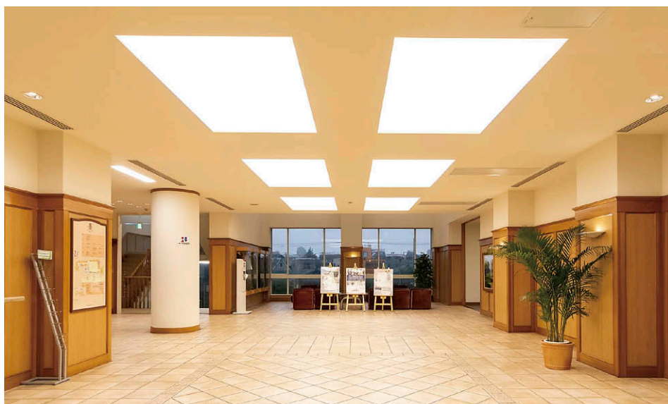
1階エントランスホールの照明 光源をLEDベースライト①にリニューアルした6面の光天井が明るい雰囲気を出している。
