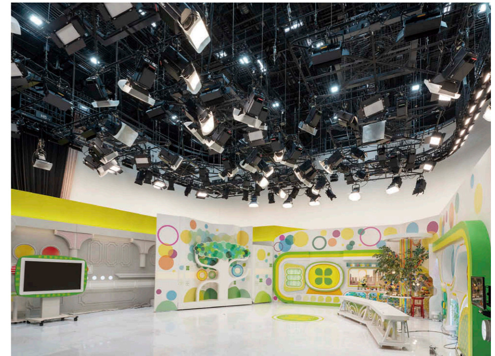
Aスタジオ 朝の帯番組「ドデスカ!」セット時。スタジオ右側に組まれたセットに対してLEDスポットライト①②、LEDブロードライト③をセッティングし、夕方の番組とのライティングを切り替え。
