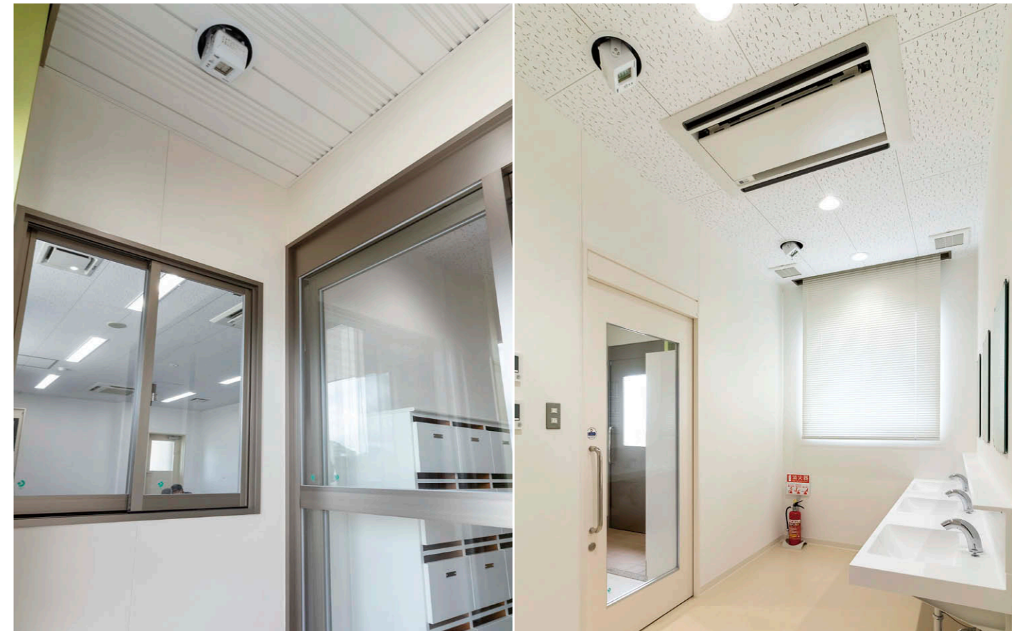
職員用玄関風除室 接触リスクのあるカウンター付近を狙ってUV照射。 調理員用出入口 健康チェックコーナーの洗面台に向けて2台のUVeeを設置。
