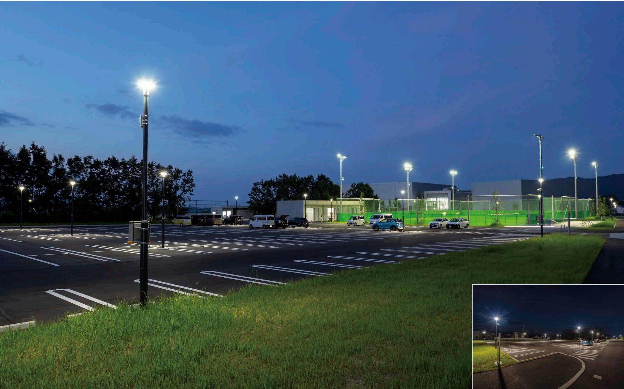
南駐車場の照明 4,450lmの明るさのLED街路灯（グレーッシュブラック）①を駐車場内に8台配置し、夜間でも視界を確保できる照明環境を創出。
