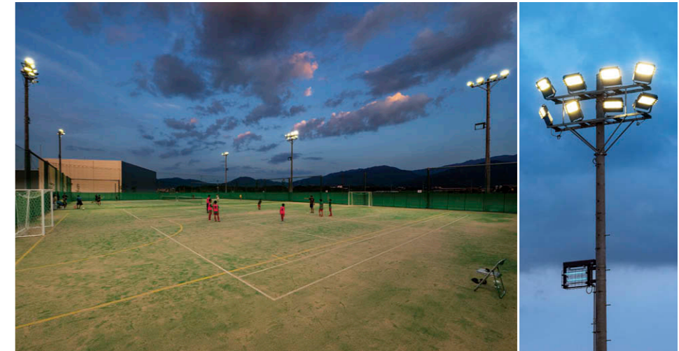
フットサルコート兼テニスコートの照明 光害対策としてルーバーを取り付けた1kW形メタルハライドランプ器具相当のLED投光器④を6柱に計32灯採用し、200ルクスの平均照度を確保。
