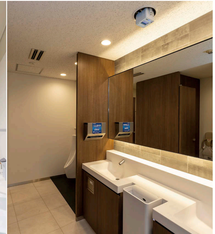
大泉学園店 男性用トイレに設置されたUVee①
