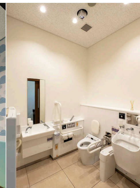
代田橋店 多目的トイレに設置されたUVee①
