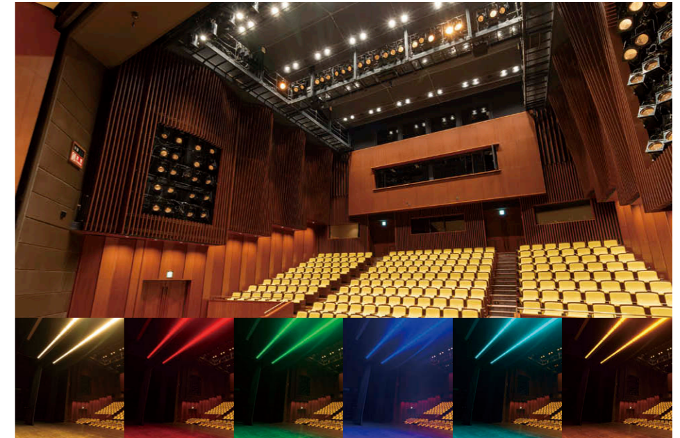
第1小ホールの照明 客席および音響反射板の天井にLEDシアターシリーズダウンライト②③を採用。舞台使用時の演出照明にフルカラーLEDボーダーライト⑥を28台設置。
