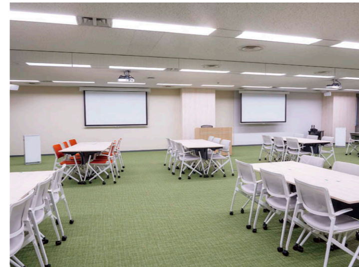
集合研修室 UVish据置タイプ200①を2台設置。
