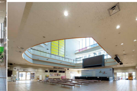
イベントホール 1階天井部にLEDダウンライト6000シリーズ①を100台、3500シリーズ②を22台採用。
