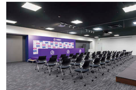
1階記者会見室 高さ3mの天井にLEDスクエア器具⑤を18台採用し、約750ルクスの明るさを確保。
