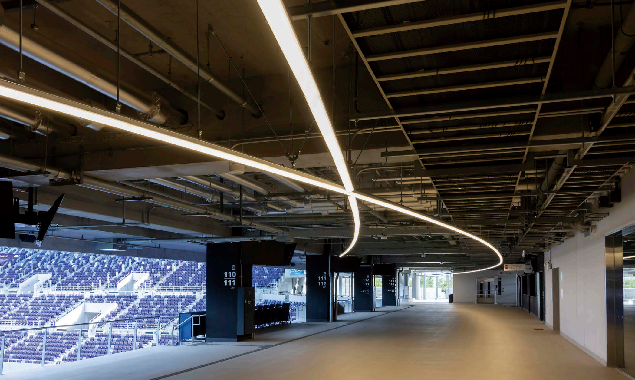
3階メインスタンド側コンコースの照明 2.65mの高さに電球色のLEDベースライト①を連結設置。柔らかな暖かみのある雰囲気、大きく緩やかな曲線を描く照明が水都広島にふさわしい水の流れを演出。
