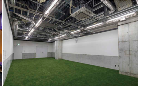
1階選手用ウォームアップスペース ガードで保護した5,200lmタイプのLEDベースライト④を32台設置。
