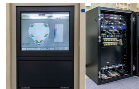
主操作盤 DMX制御盤
