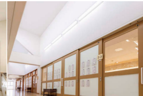
家庭科室の照明 LEDベースライト①を18台採用。
