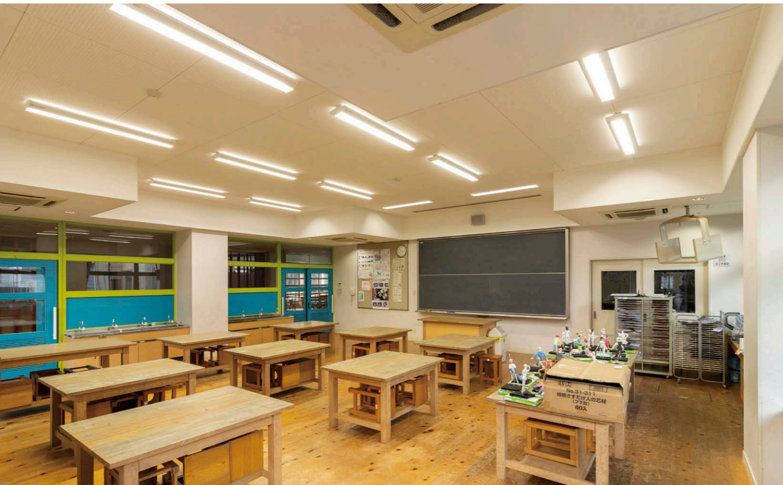
図工室 LEDベースライト①②による照明。
