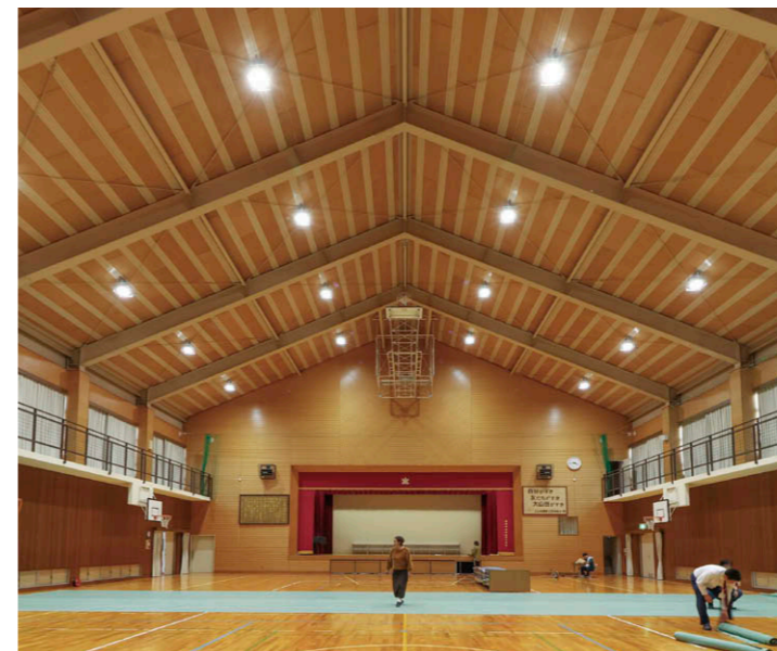
体育館 LED高天井器具④による照明。
