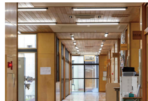
廊下 LEDベースライト③による照明。
