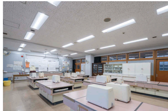
家庭科室(三の丸小学校) LEDベースライト①による照明
