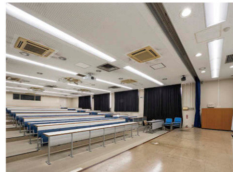
大教室 TENQOOシリーズ埋込形の連結用器具③を採用し3台連結して配置。
