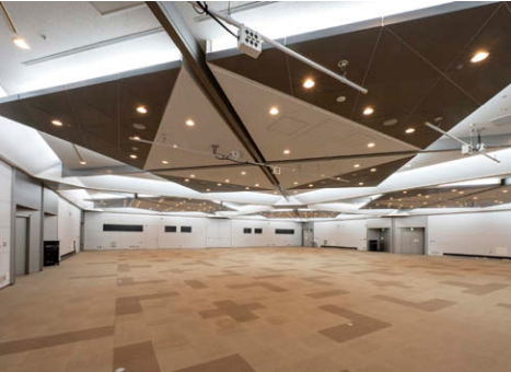
会議室 (605～608連結) LEDダウンライト⑥、TENQOOシリーズ⑦のほか電源ユニットも設備。
