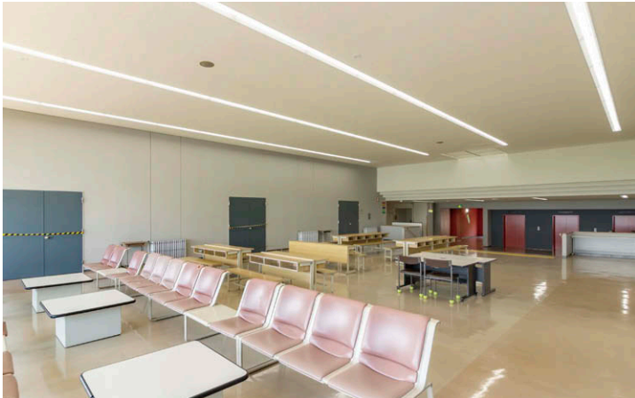
多目的スペース 様々な活用方法が考えられる共有スペースの照明
