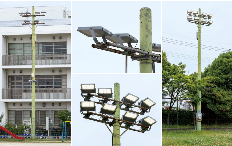
グラウンド照明器具の設置状況(消灯時/点灯時) 既設コンクリートポールの高さ13mの位置にLED投光器①をほぼ真下に向けて設置し、利用者の視界に入る発光面を小さくすることで眩しさを軽減
