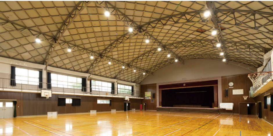
体育館の照明 400W形金属ハイドランプ器具相当のLED高天井器具②を8台×3列で配置 接続安定性に優れた920MHz帯域を使用した無線調光シリーズSceneLEDを採用しているため、体育館の使用目的に合わせてリモコンで簡単にグループ操作、シーン操作が行えるだけでなく、器具1台単位での明るさ調整も可能
