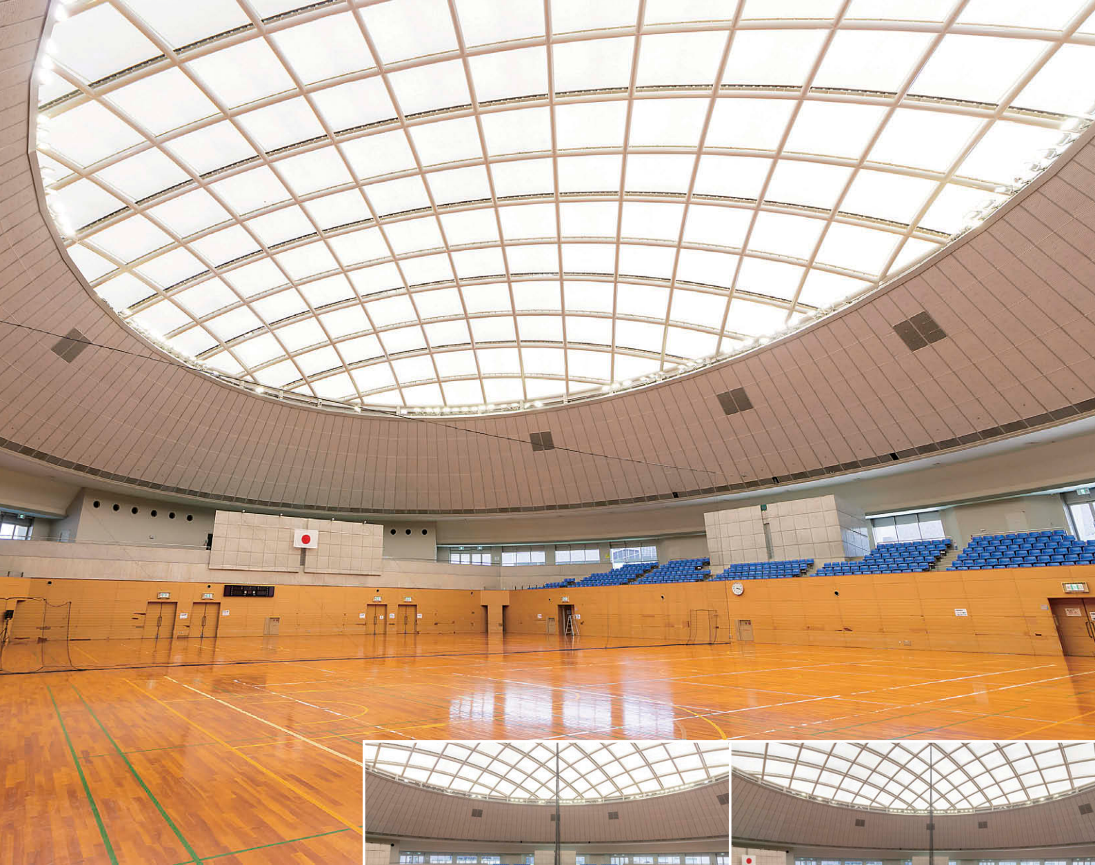
メインアリーナの照明 LED投光器①②③ 計100台により明るさを確保しながら眩しさを抑えた快適なスポーツ環境を実現
