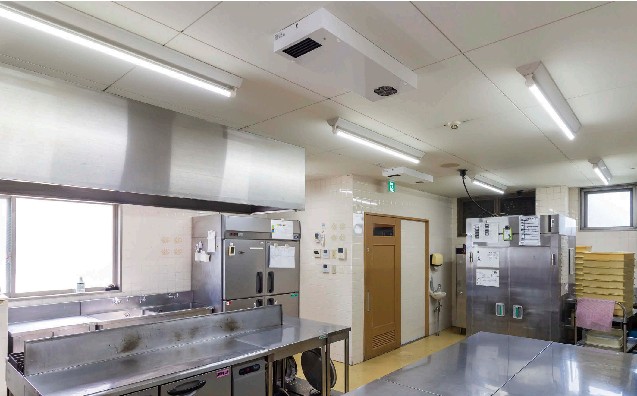
調理室 LED殺菌灯器具空気除菌機①2台を天井に設置
