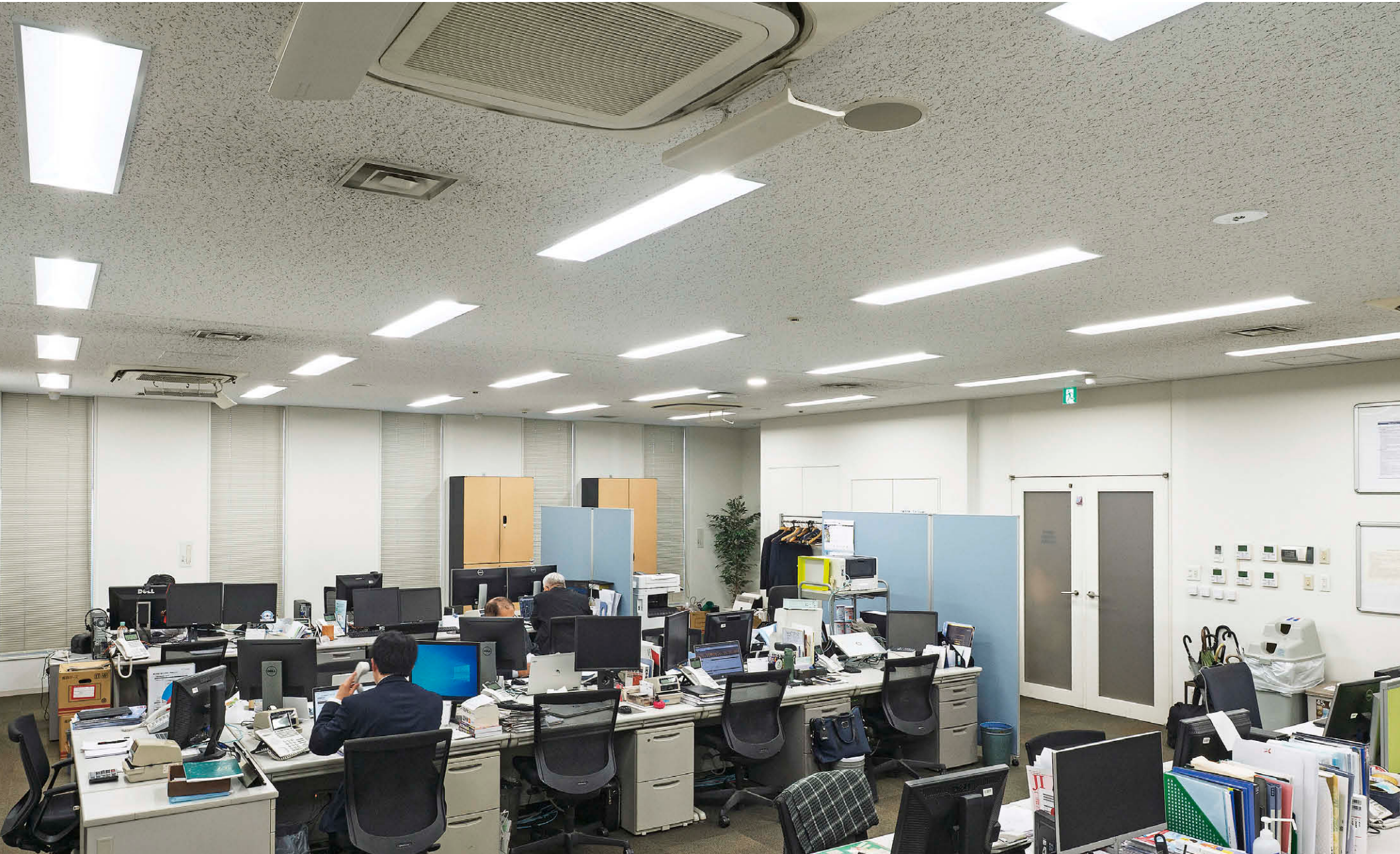
1階事務室の照明 無線調光対応の6,900lmタイプLEDベースライト埋込形①を5×5の計25台設置 室内を3つのエリアに分け、フロア一括制御用も含めて4台の壁操作器で、設定された19の調光パターンから最適な照明環境を選択
