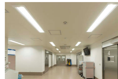
4階手術室準備ホールの照明 昼白色のクリーンルーム向けLEDベースライト③を8台配置
