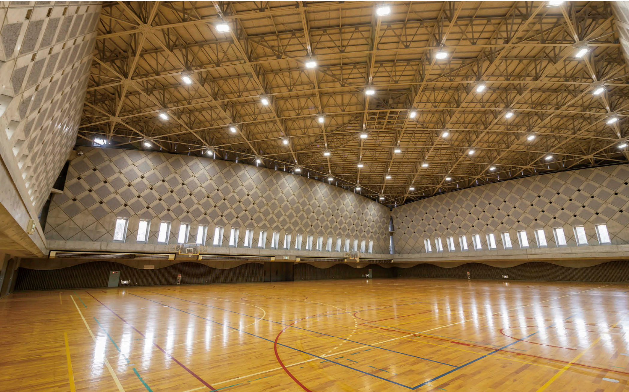
アリーナの照明 広さ47m×31m、天井高13.6mのアリーナにLED高天井器具①を47台設置し、採光窓にはLEDユニット交換形ダウンライト②を採用
